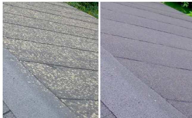
Tak av papp med angrepp av lav. 3 år efter behandling av Grön-Fri. Inget efterarbete.
